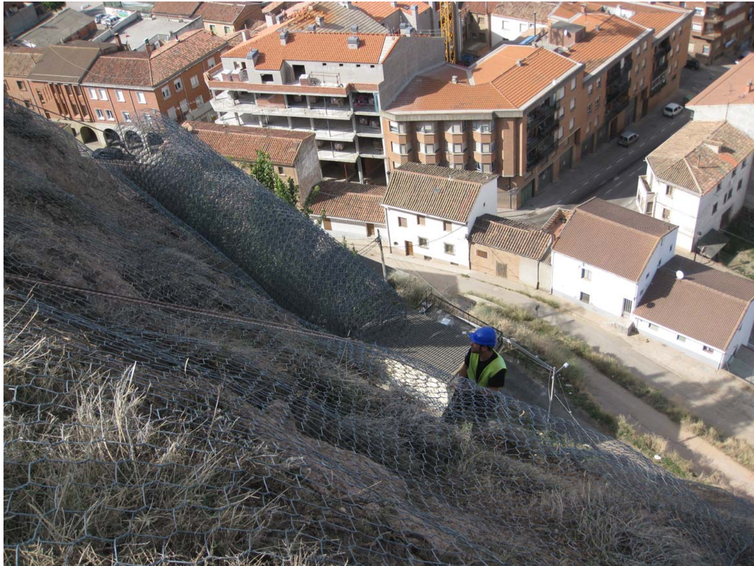
Detalle de los trabajos de extendido de los paños de malla, visto desde la cabecera del talud
