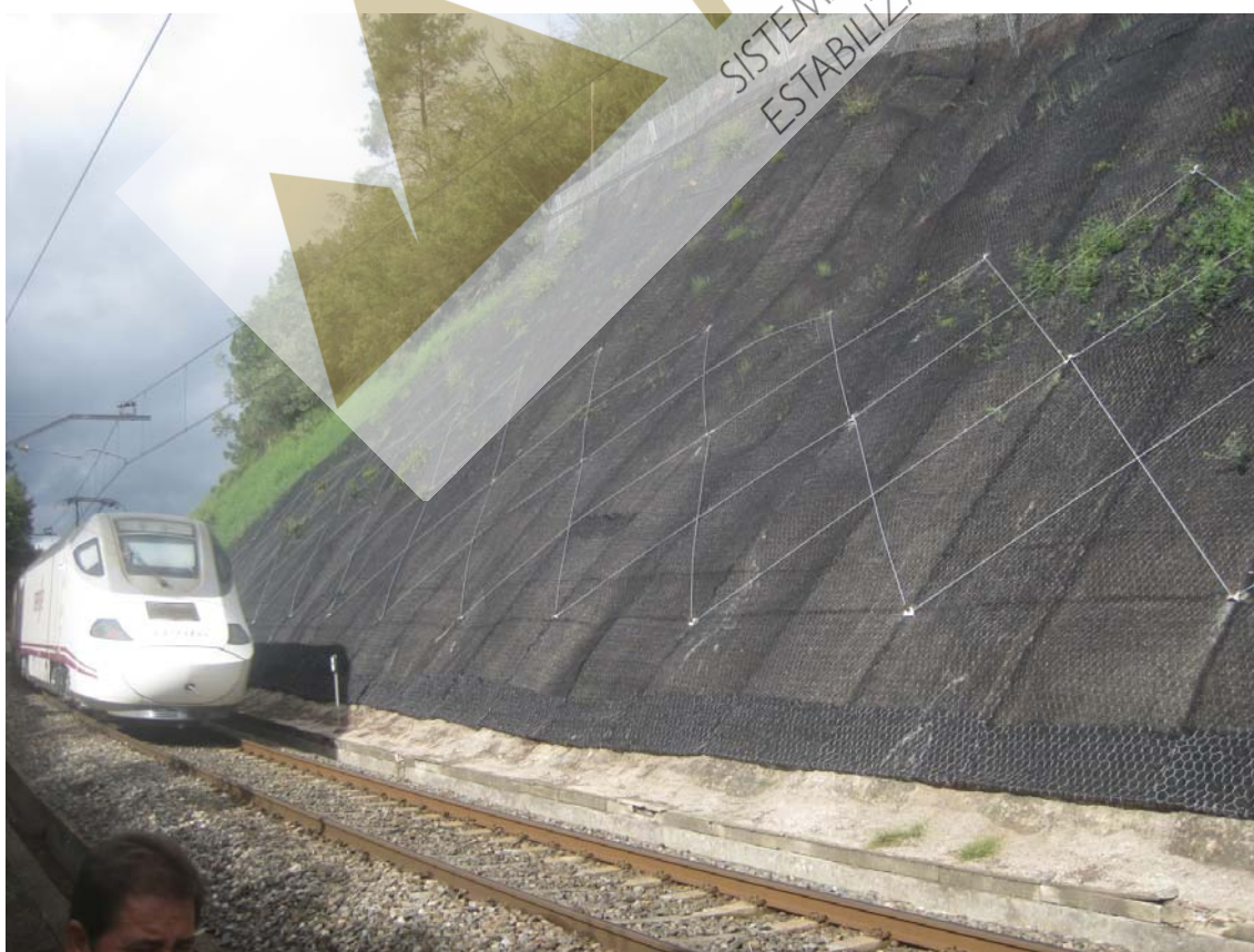
SECTOR 4 Vista parcial de la trinchera, previa y posterior a la colocación de geomalla y malla de triple torsión y barrera embudo en la zona superior
