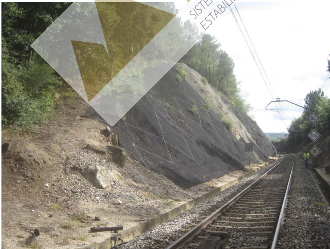
SECTOR 1 Vista parcial de la trinchera, previa y posterior a los trabajos de estabilización mediante geomalla y malla de triple torsión reforzada
