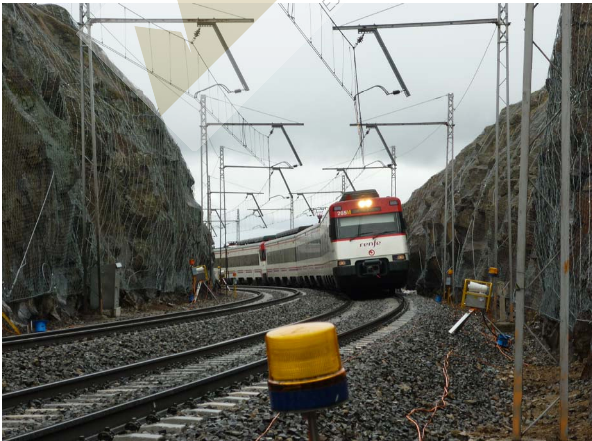
Detalle de los trabajos de colocación y bulonado de la malla de triple torsión
