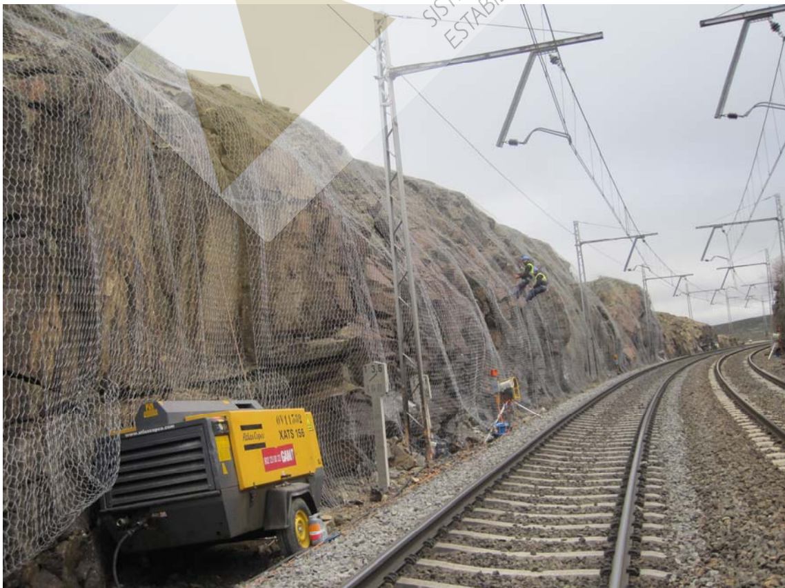
Vista parcial de la trinchera, previa y durante los trabajos de colocación de malla de triple torsión.
