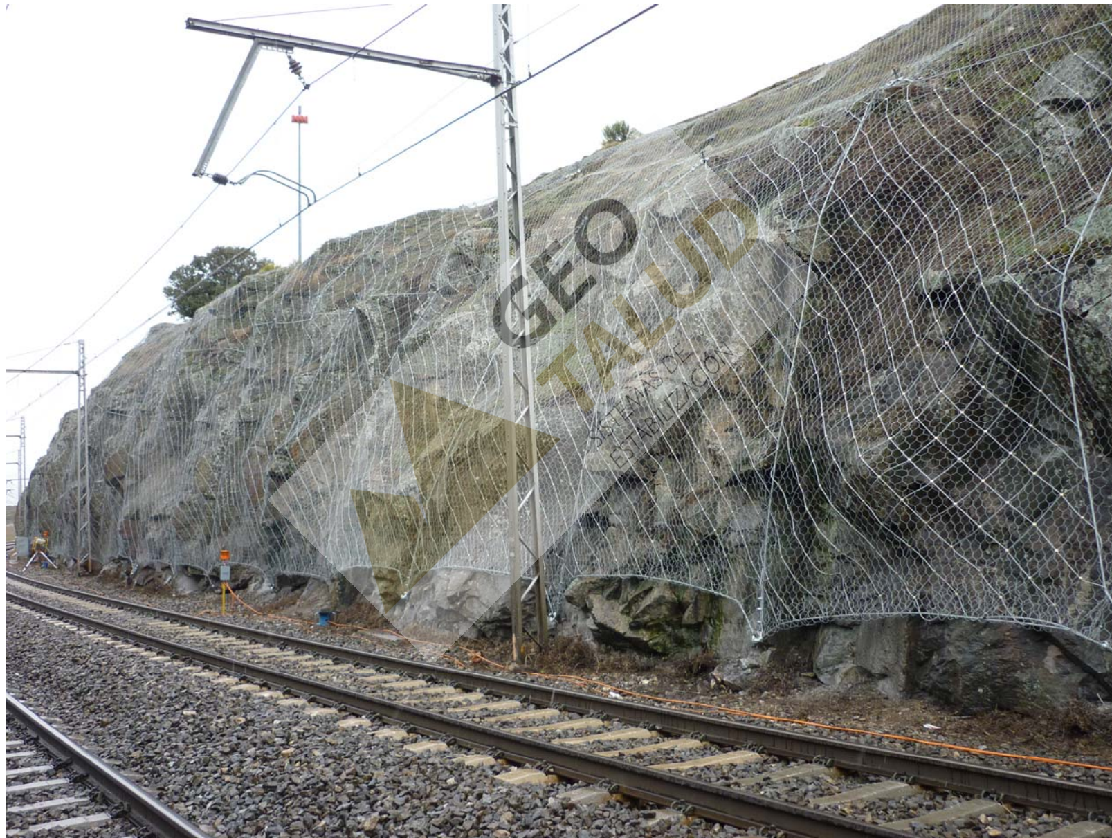
Detalle de uno de los taludes estabilizado con redes de cable de acero
