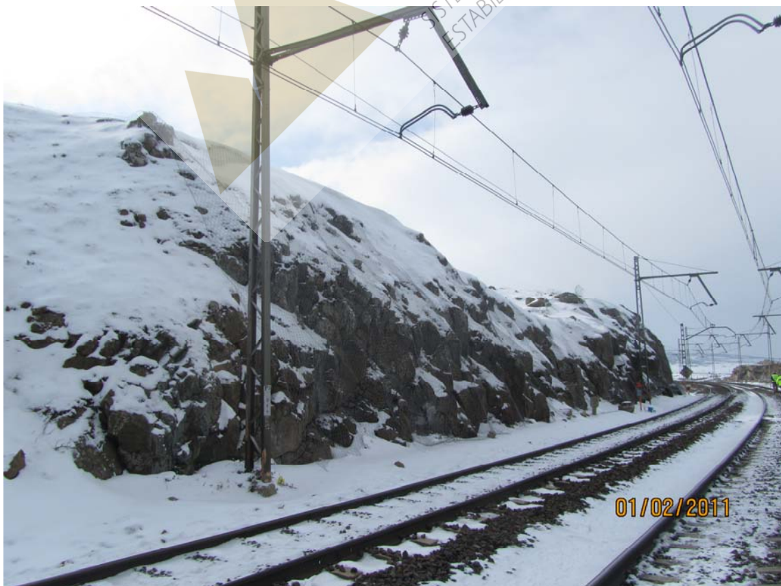
Vista parcial de la trinchera, previa y durante los trabajos de estabilización
