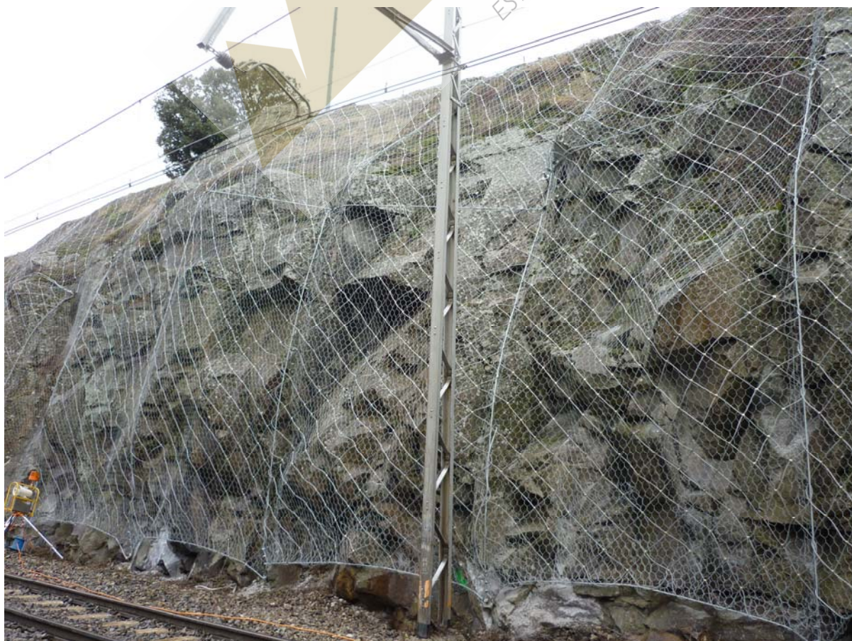
Rede de cable de acero y malla tipo Bianmat
