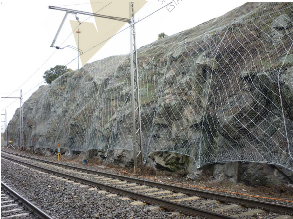
Vista parcial de la trinchera, previa y durante los trabajos de estabilización mediante red de cables de acero.
