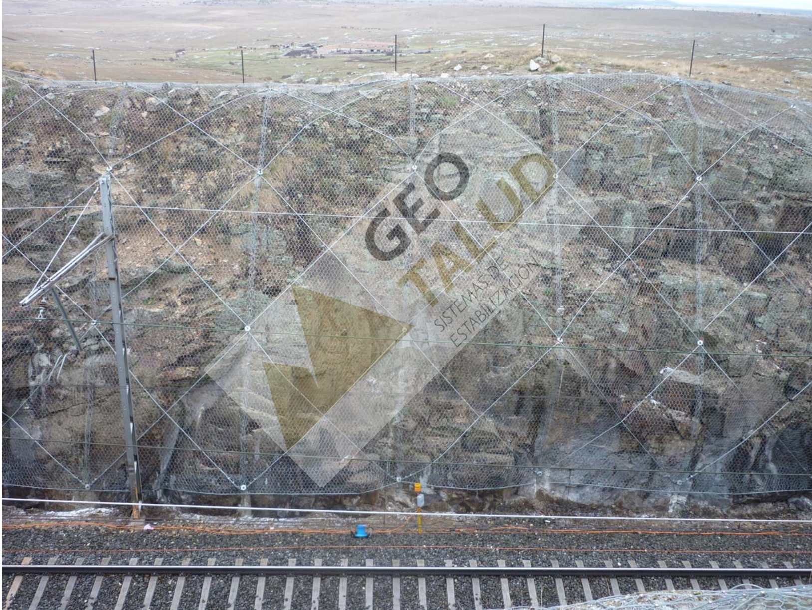
Detalle de uno de los taludes estabilizado con malla de triple torsión, reforzada con bulones y cuadrícula de cables
