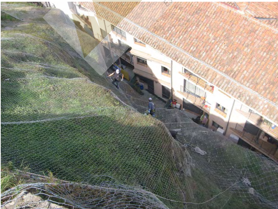
Vista del talud y detalle de los trabajos de extendido de paños de malla de triple torsión y red de cable de acero
