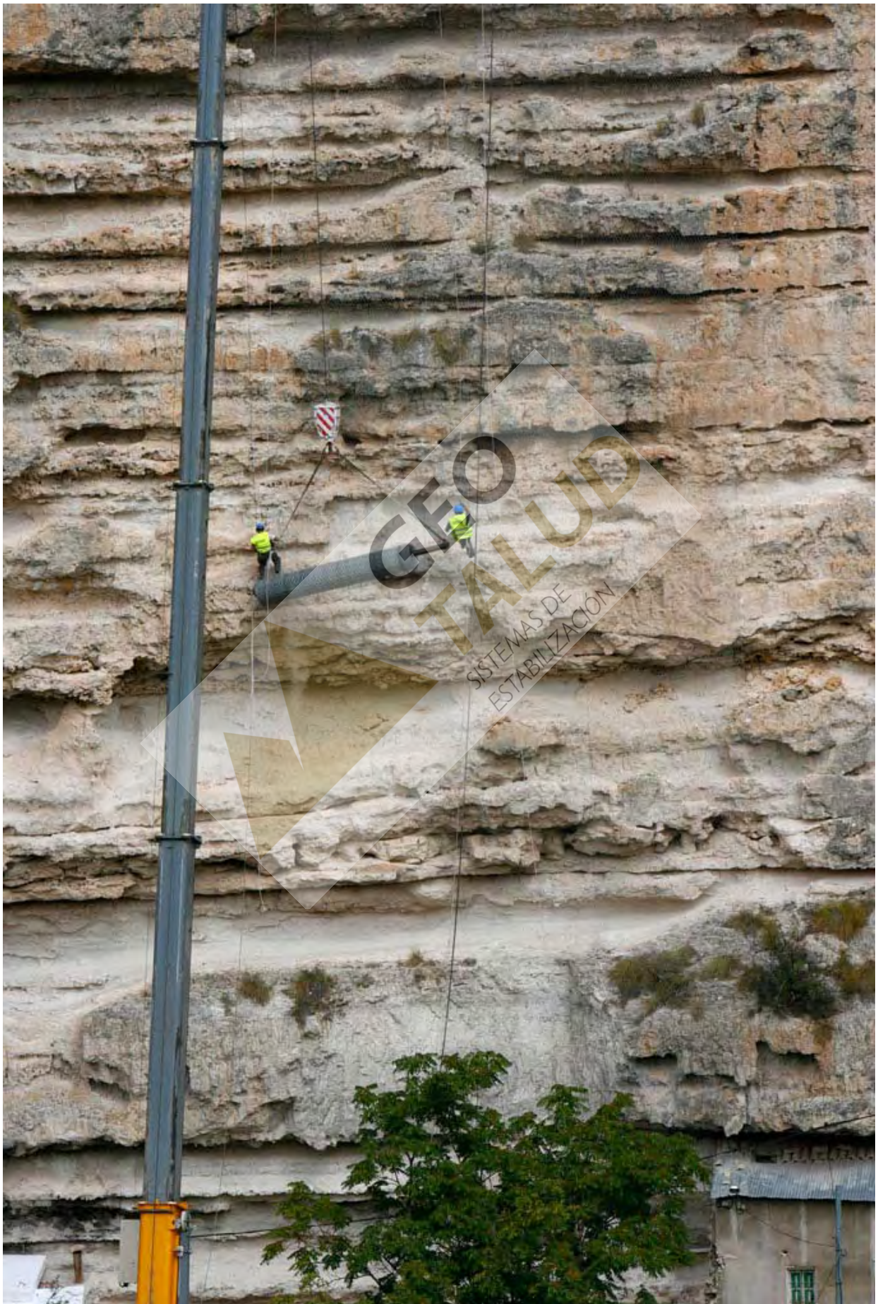
Detalle extendido paños de malla de triple torsión y red de aros de cable
