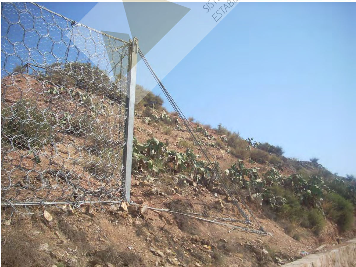
Detalle de los postes extremos de la barrera dinámica y sus anclajes al terreno.
