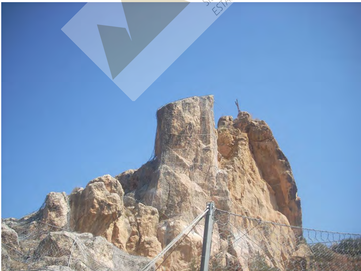
Vista parcial del cabezo, previa y posterior a su estabilización y a la colocación de la barrera dinámica .
